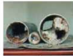
油のつまった宅地内配水管
