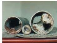
油のつまった宅地内配水管
