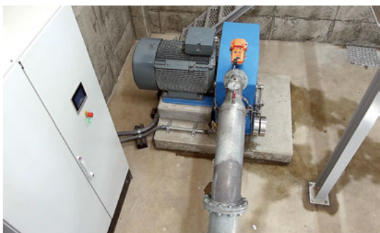
神戸小水力発電施設 (発電容量：最大49kW)
