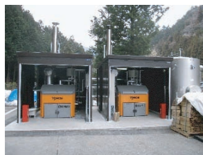
薪ボイラー 数馬の湯の風呂加温や給湯に
